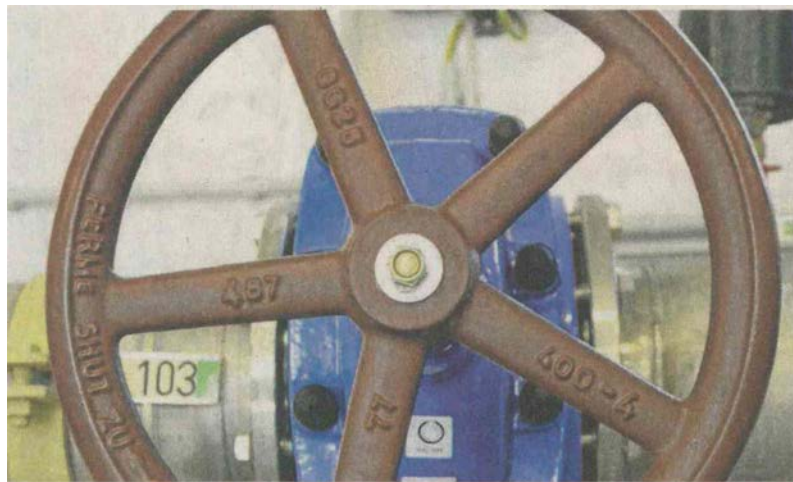
Ein Schieber im Wasserwerk Ullrichsberg bei Eisenberg. FOTO: FLORIAN GIRWERT
